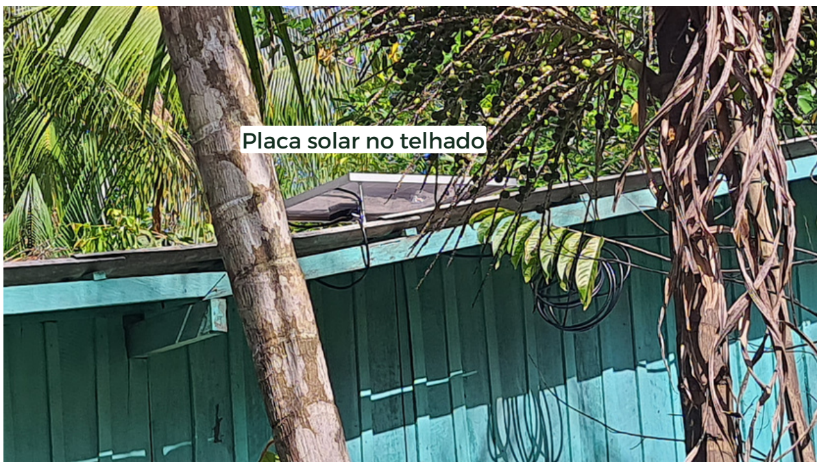
Figura 5 - Visão geral externa do sistema de energia solar
