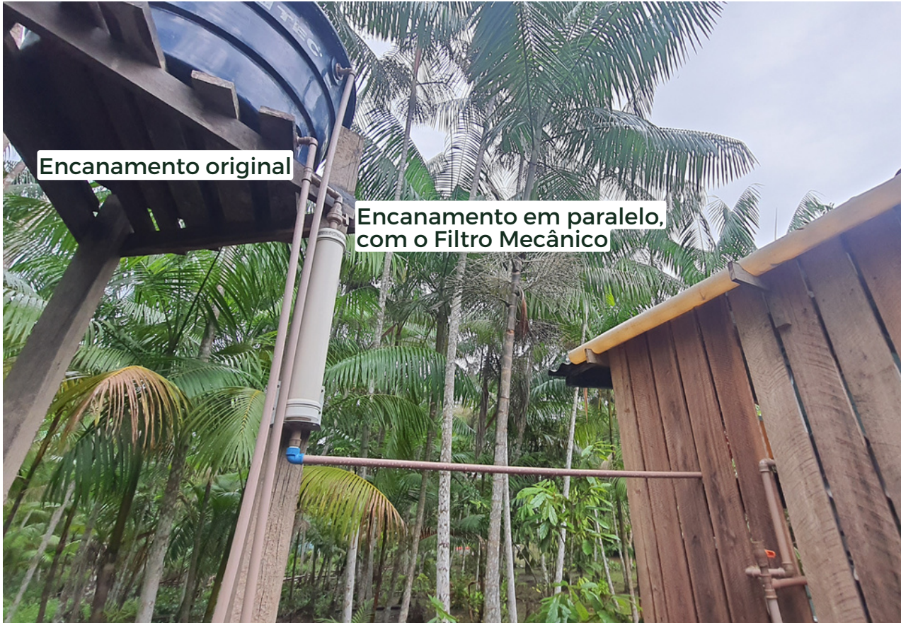
Figura 1 - Visão geral da montagem do Filtro Mecânico
